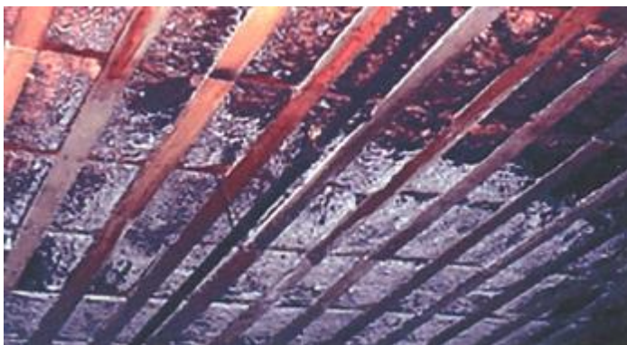
Plafond d'un entrepôt réfrigéré contaminé à cause de l'accumulation de poussières et de la condensation.
